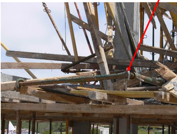
Fotografía 6. Varias vistas del encofrado de la losa tras su colapso. (INVASSAT)
