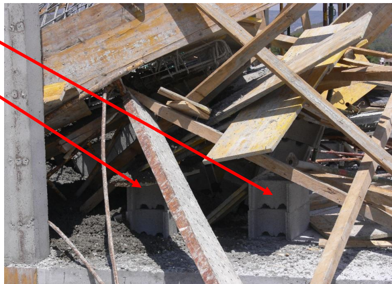
Fotografía 2. Dos vistas en detalle de la suplementación de los puntales que no llegaban al encofrado. (INVASSAT)
