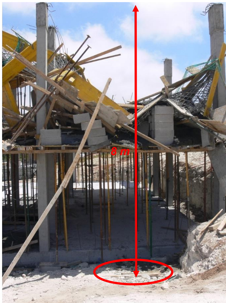
Fotografía 4. Lugar donde cae el trabajador accidentado desde unos 8 metros de altura. (INVASSAT)
