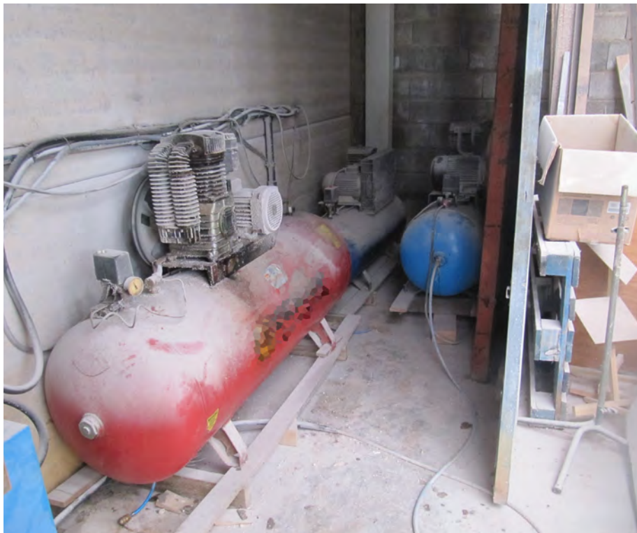
Compresores de aire (fijo y portátil) utilizados en el taller. INVASSAT
