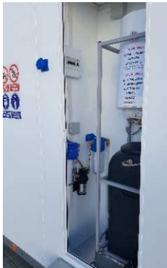
CALENTADOR DE AGUA Y SIST. DE FILTRACIÓN
