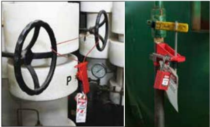
Figura 9. Bloqueo de válvulas (Brady) con LOTO.
