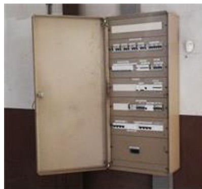
Fotografía 1. Cuadro con protecciones
