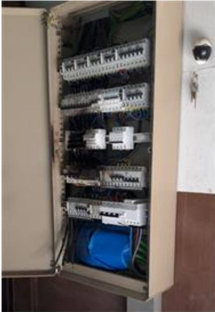
Fotografía 2. Cuadro sin protecciones
