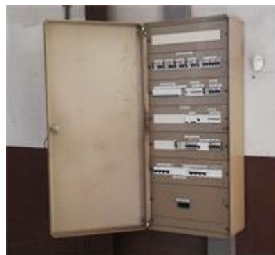
Fotografia 1. Quadre amb proteccions
