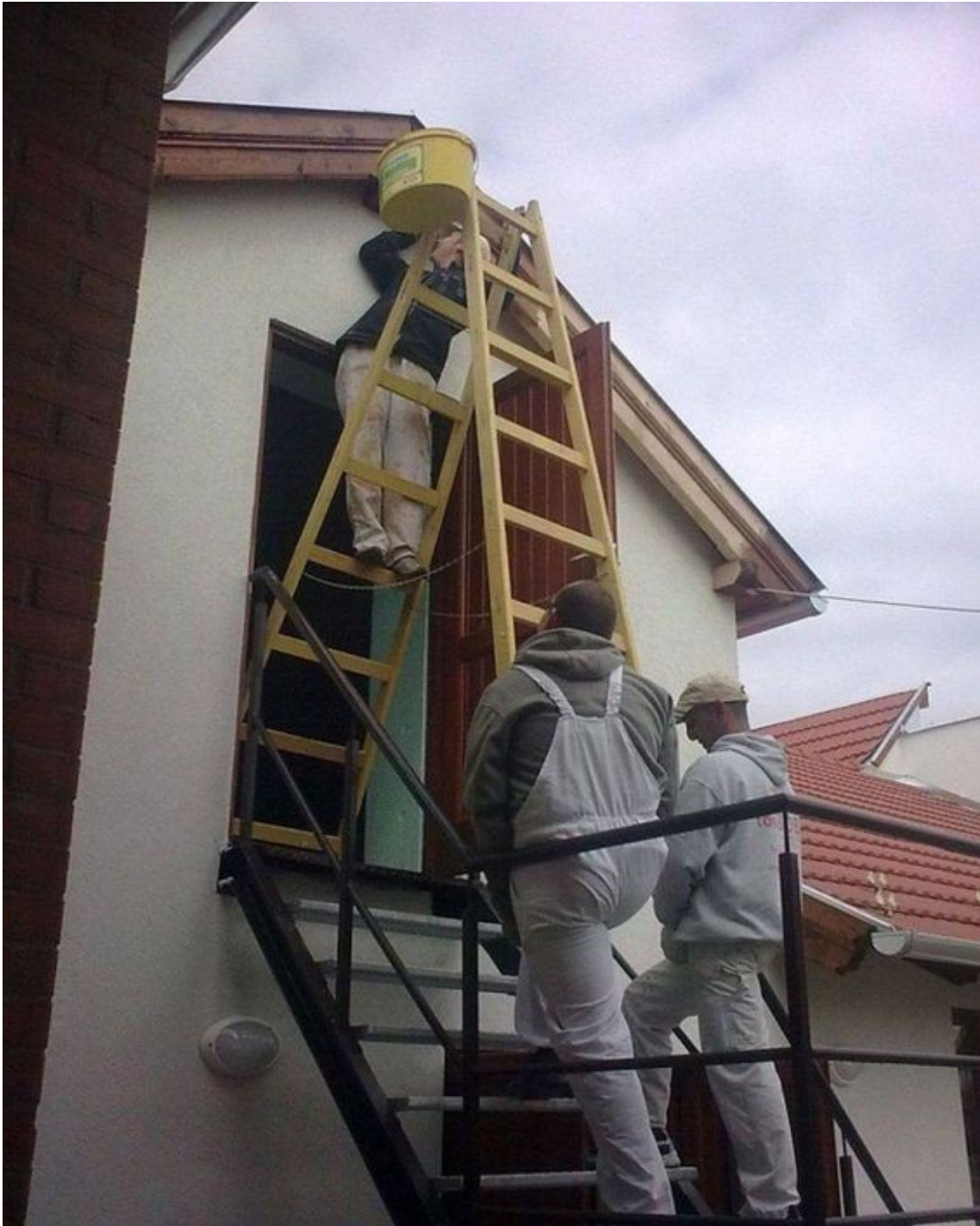
10 impactantes fotos en prevención de riesgos laborales que no te gustaría encontrarte, en Prevenir
