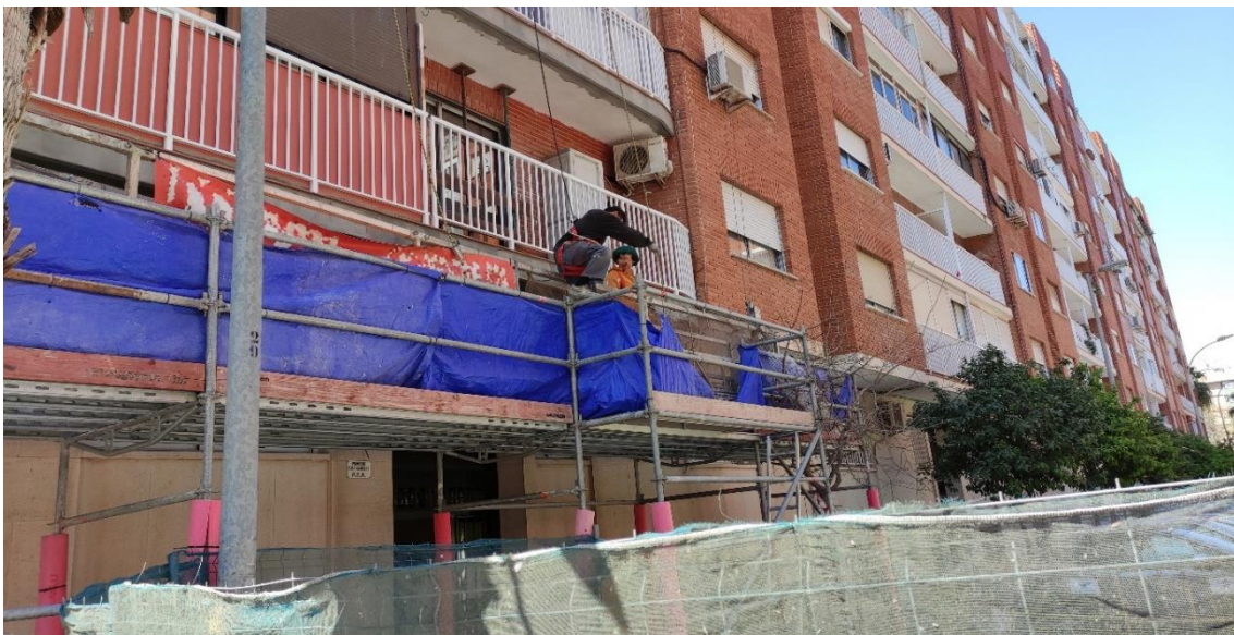
Fotografía 2. Ejemplo de un trabajador saliendo de la plataforma de un andamio colgado subiéndose y pasando por encima de la propia barandilla del mismo al carecer esta de medio de acceso cómodo y seguro. En este caso, el trabajador saltaba de la plataforma del andamio colgado a un andamio metálico tubular con escalera interior que se había instalado a modo de marquesina y que se empleaba para acceder del nivel de calle al nivel de la plataforma del andamio tubular sobre el que descansaba el andamio colgado. INVASSAT.
