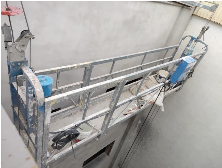
Fotografía 1. Ejemplo de un andamio colgado cuya plataforma de trabajo carece de un acceso tipo puerta o similar. INVASSAT
