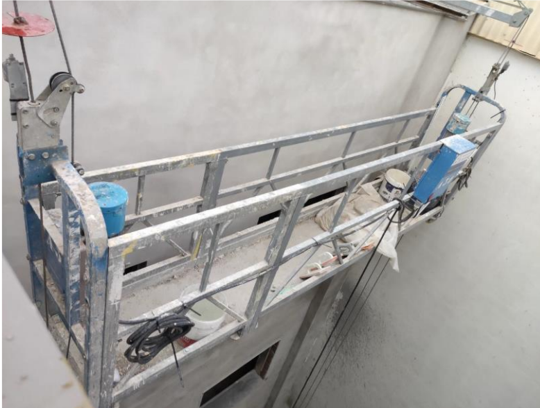
Fotografia 1. Exemple d'una bastida penjada la plataforma de treball de la qual manca d'un accés tipus porta o similar. INVASSAT
