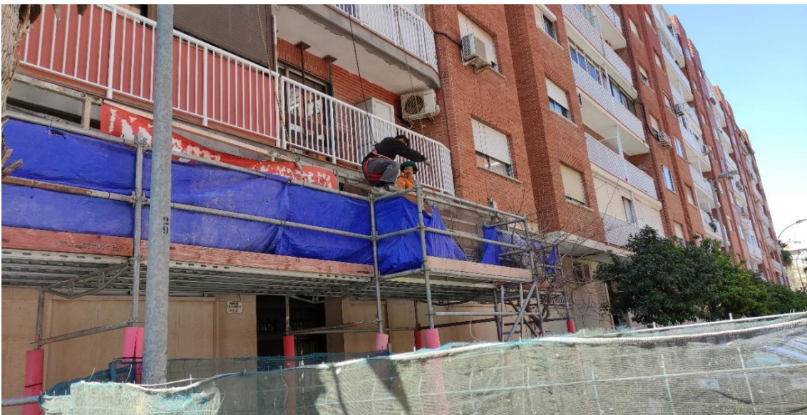
Fotografia 2. Exemple d'un treballador eixint de la plataforma d'una bastida penjada pujant-se i passant per damunt de la pròpia barana del mateix en manca aquesta de mitjà d'accés còmode i segur. En aquest cas, el treballador saltava de la plataforma de la bastida penjada a una bastida metàl·lica tubular amb escala interior que s'havia instal·lat a manera de marquesina i que s'emprava per a accedir del nivell de carrer al nivell de la plataforma de la bastida tubular sobre el qual descansava la bastida penjada. INVASSAT.
