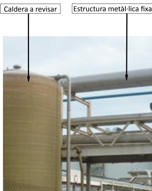
Figura1: disposició de la caldera i l'estructura auxiliar
