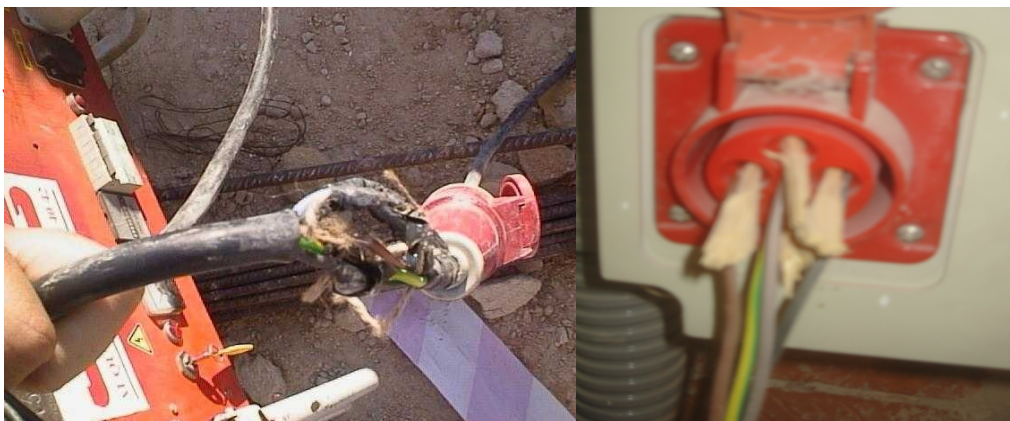
Situaciones inaceptables de falta de aislamiento eléctrico
